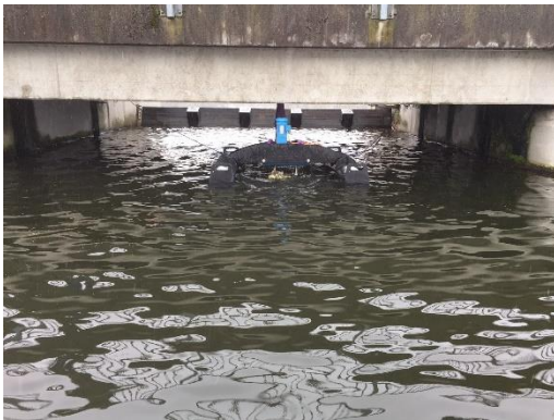
23.1.2018 OLOID Typ 400 mit Strömungsrichtung zur Wehrklappe
